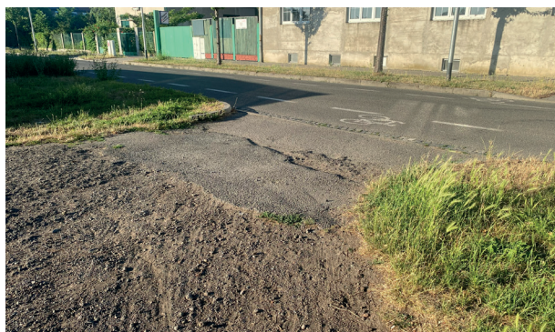
rozbitý asfalt, špatný stav navazujících komunikací v parku
