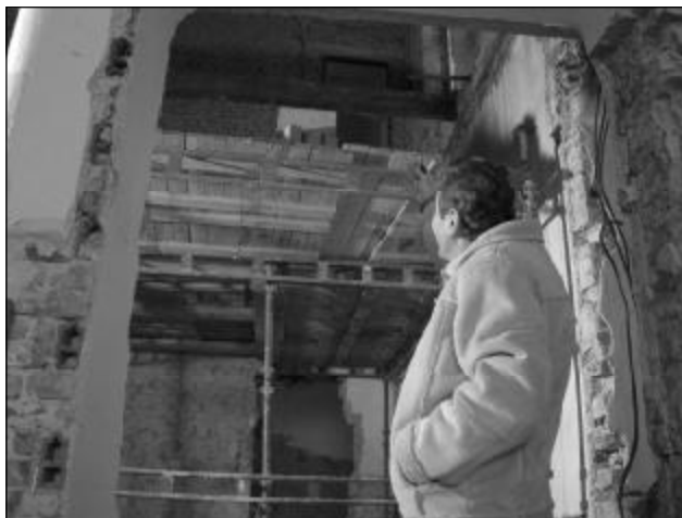
Ředitel společnosti Jižní Morava Jaroslav Mozga ukazuje na zadní část bývalé prodejny, kde po nutné rekonstrukci prvního podlaží zůstalo jen obvodové zdívko.
