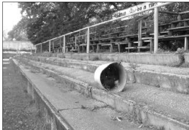
Zanedbaný areál Tatranu čeká spousta oprav.
