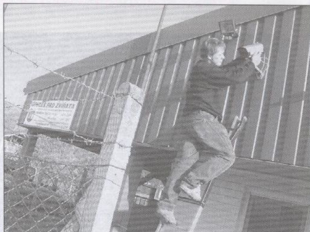
Kamery technici rozmístili vně i uvnitř útulku.
