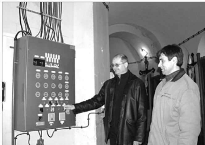
Desítky let starou rozvodnou skříň v zákřistii chce farář Vladimír Langer vyměnit za malý ovládací panel. Ze stěn tak zmizí spousty nevzhledných kabelů.
