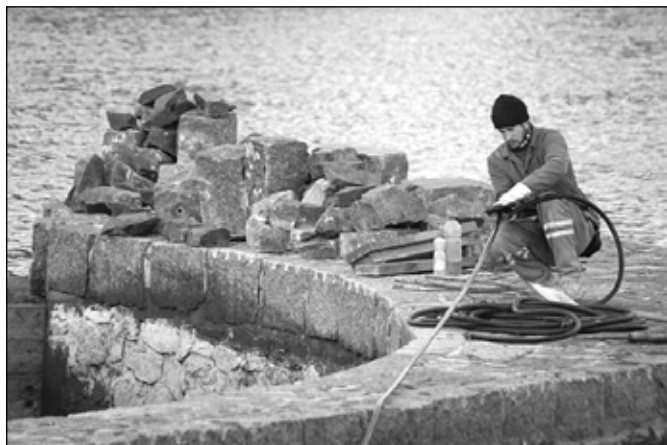
Opravy na rybím přechodu finišují. Kontrolní odchvy ryb ukáží, zda přechod opravdu začne plnit svoji funkci. Foto David Mahovský
